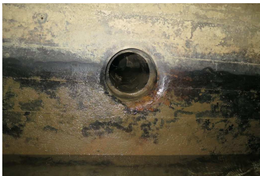
Figura 42. Opera di presa esistente.
